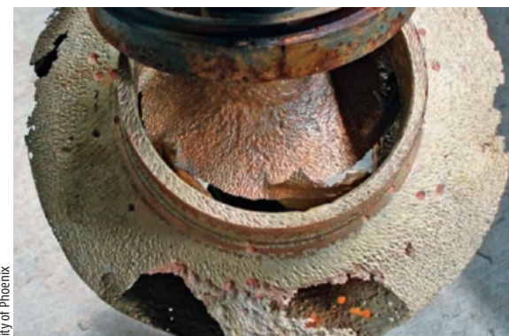
Abb. 1 – Durch Sandführung zerstörtes Pumpenlaufrad
