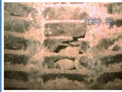
Abb. 1 – Korrosionsschaden bei 263 Fuß unter GOK. In der Bildmitte ist deutlich Blockkies des alluvialen Ausgangsgesteins zu erkennen. Die Filterlamellen sind durch die Korrosion auf circa 3 Zoll aufgeweitet.
