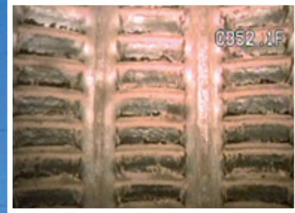
Abb. 2 – Korrosionsschaden bei 352 Fuß unter GOK. Die Filterlamellen sind erkennbar korrodiert, die Verkiesung ist nicht mehr vorhanden.
